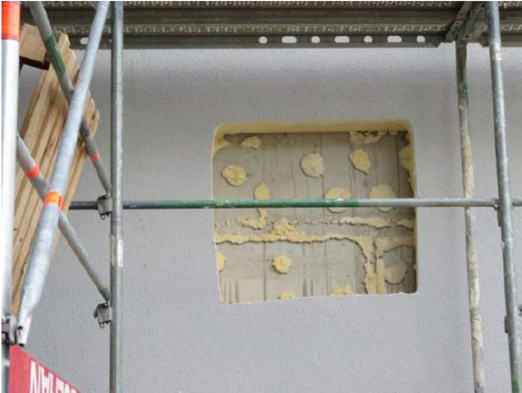
Ungenügende Kontaktfläche der Verklebung
