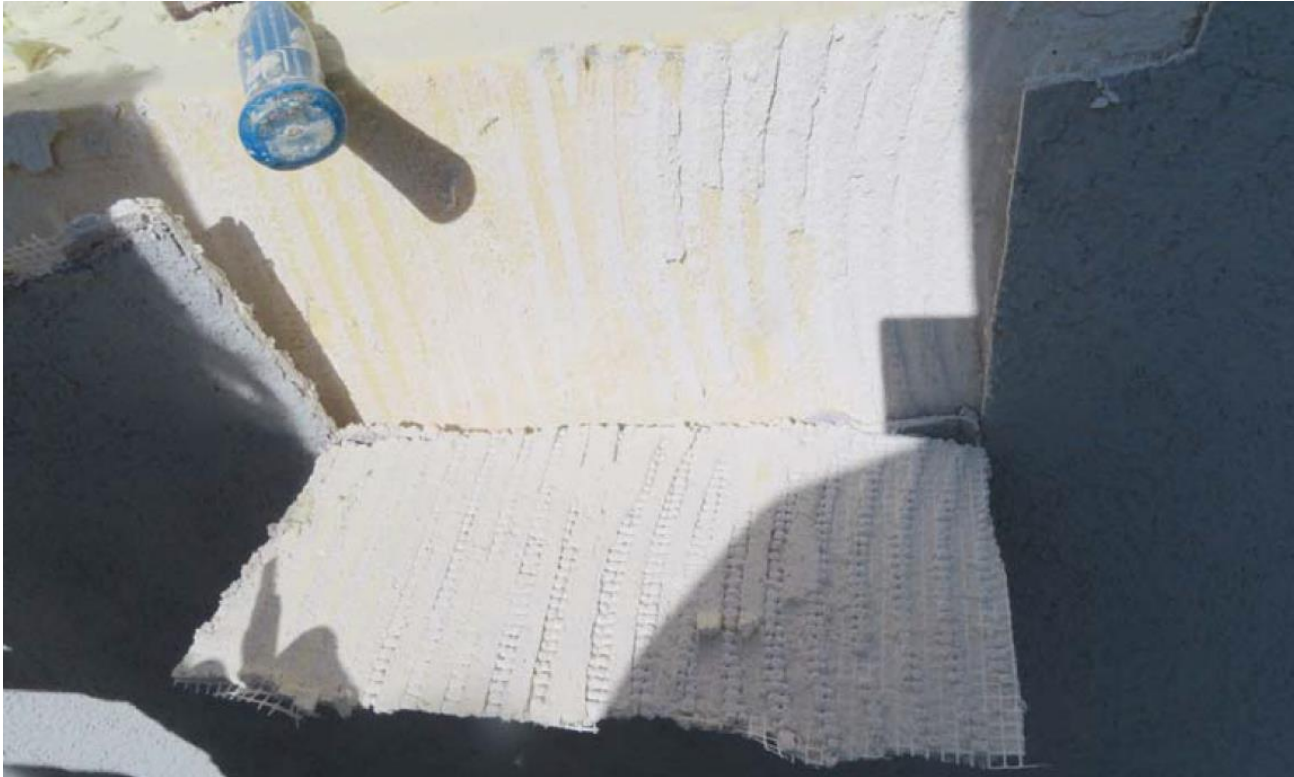
Ungenügende Haftzugfestigkeit der Armierungskleberschicht an den Platten
